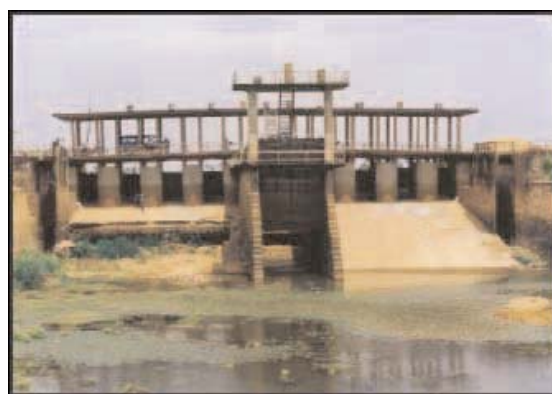
ຝາຍຊົນລະປະທານທີ່ Stung Chinit, ສາຂາແມ່ນ້ຳຕົງເລສາບ, ສ້າງໃນສະໄໝຂະເມນແດງ ຈະໄດ້ຮັບການປັບປຸງໃນໄວໆນີ້ ແລະຕິດຕັ້ງທາງຜ່ານຂອງປາໃສ່ເພື່ອໃຫ້ປາຢູ່ກ້ອງຝາຍສາມາດຜ່ານໄດ້
